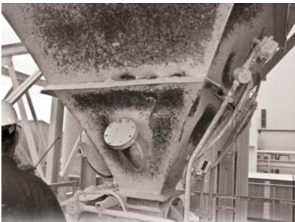
Удары по бункеру могут повредить поверхность стен.
