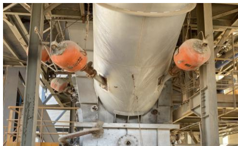
29 canons à air Martin® Hurricane ont été installés à des emplacements stratégiques.
