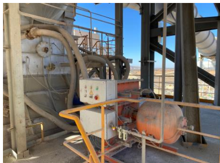
L'installation a permis d'améliorer immédiatement les performances de production.
