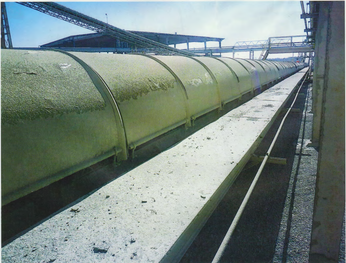
5 Diese Kabelrinne blockiert den Zugang für den effizienten Austausch von Spannrollen • This cable tray blocks access for efficiently replacing idlers
