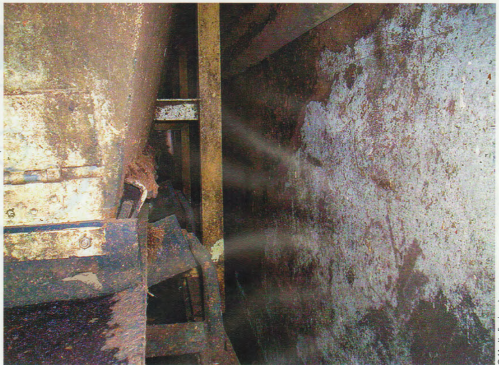
10 Dieses Förderband wurde so nahe an einer Tunnelwand positioniert, dass Wartung und Aufrüstung extrem schwierig sind • This conveyor was positioned so close to a tunnel wall that service and upgrades are extremely difficult
