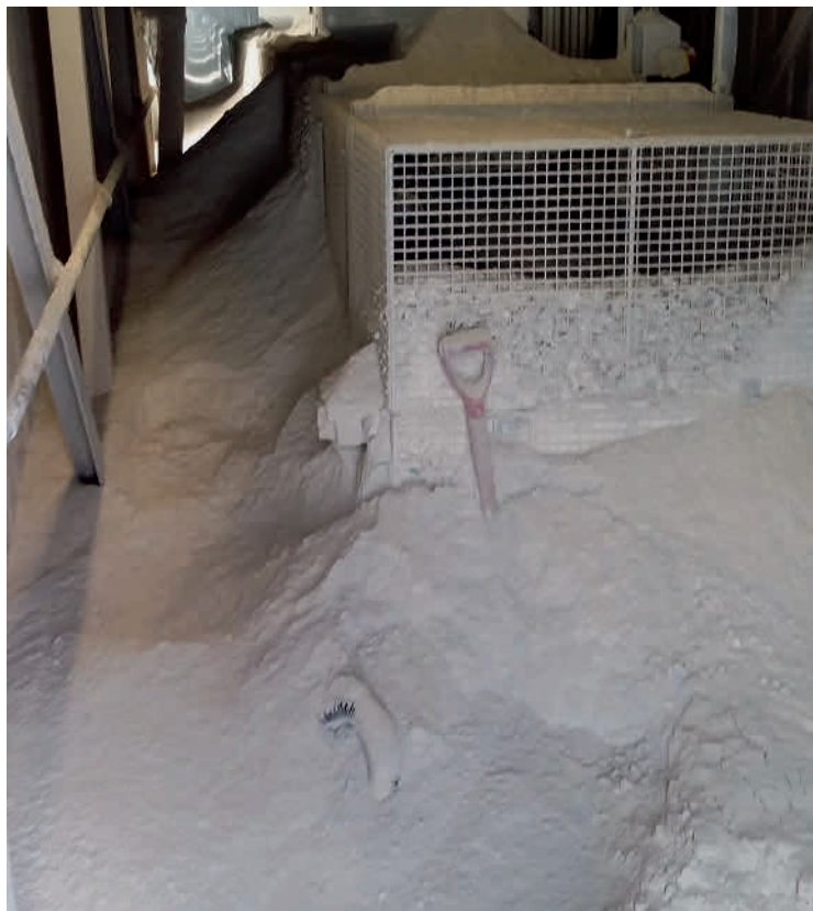
1 Hoch genug, um die Riemenscheibe zu verkapseln, stellen die vom Staub blockierten Laufbühnen eine potentielle Gefahr dar Piled high enough to encapsulate the tail pulley, the dust blocked walkways, posing a potential hazard
